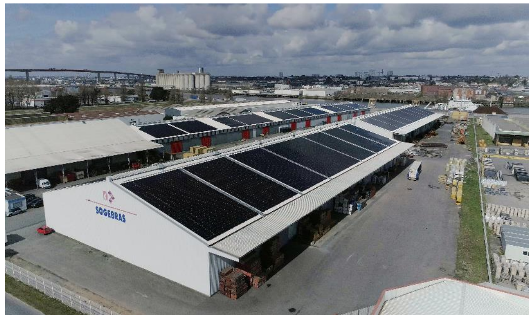
Figure 10 : centrale photovoltaïque en toiture de Cheviré
