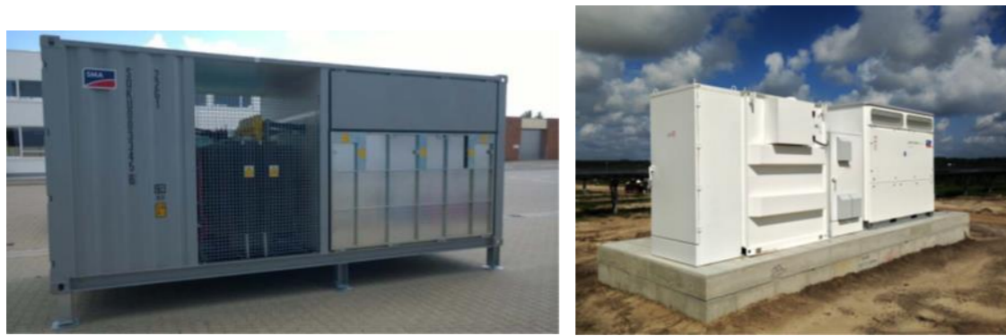
Figure 85 : Exemples de locaux techniques abritant les postes de transformation (source JPee et SMA)
