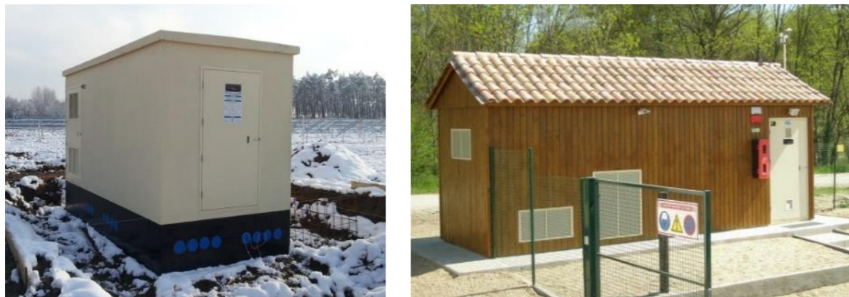
Figure 86 : Exemples de postes de transformation (source JPee)
